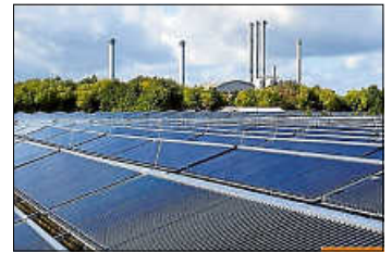
Kommunale Wärmenetze Foto: Deutsches Institut für Urbanistik
